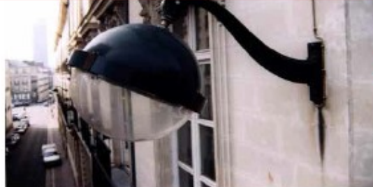
Luminaire sur façade
