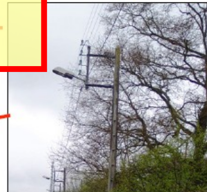
Le réseau aérien
