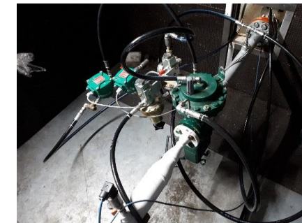
Solution RAF installée sur le poste de Trémentines Le Mesnil
