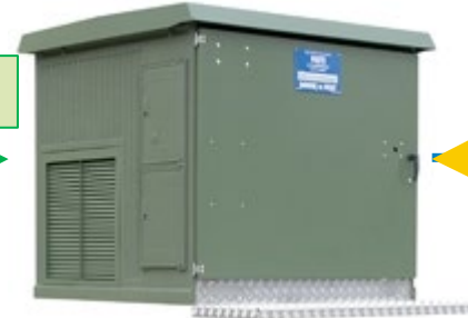
Poste de livraison
